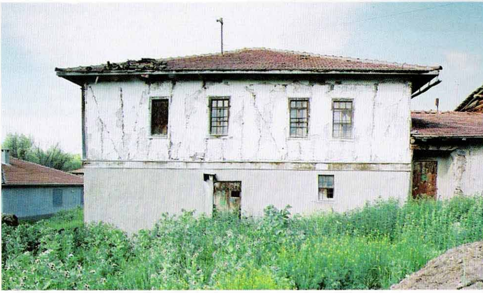
Az hasarlı bir ahşap yapı; Çankırı, Orta.
