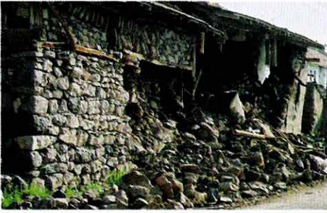
Orta Depremi'nde hasar gören geleneksel bir yapı.
