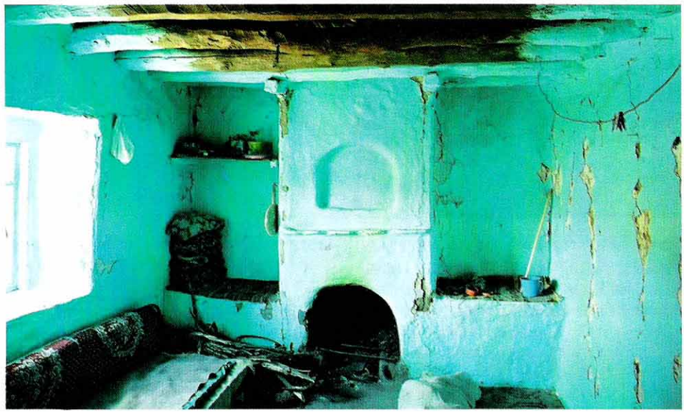
Ahşap iskeletli yapıda deprem sonrası ortaya çıkan çatlaklar; Çankırı, Orta.
