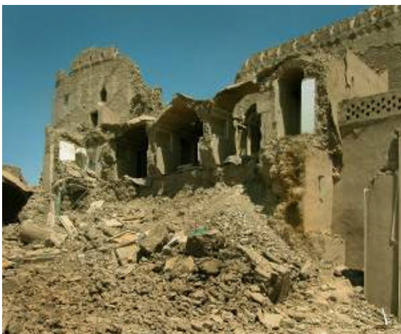
Figura 14. Edifici sopra al cortile della stalle crollate per la divaricazione laterale dei muri e dei riempimenti di sostegno che stavano al di sotto.
