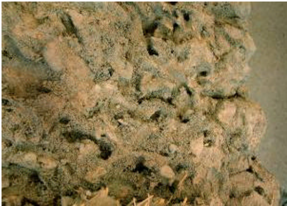
Figura 2. Segno dei danni dovuti alle termiti in un muro della cittadella di Bam dove ci sono estesi depositi di palline fecali e tunnel dovuti agli insetti.
