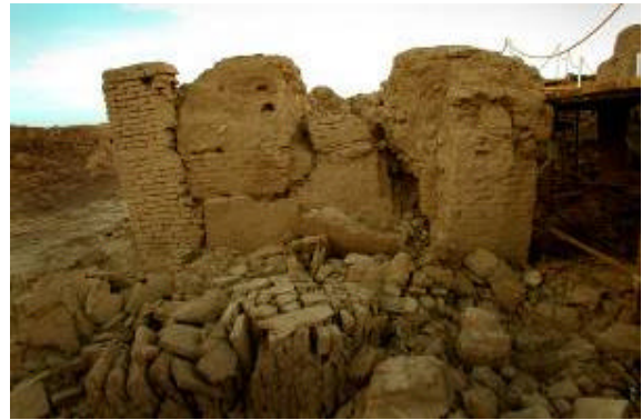
Figura 17. Pilastro massiccio composto da khesht e chineh di differenti tipi e periodi che sono stati separati l'uno dall'altro durante il sisma.
