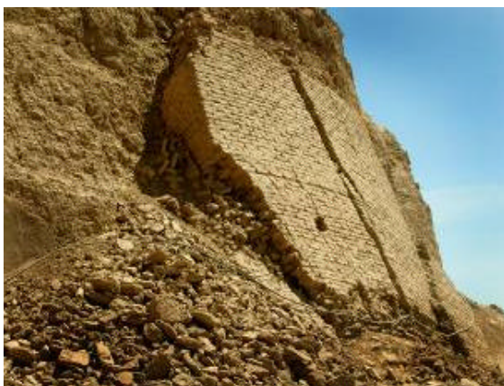
Figura 7. Veduta delle mura esterne crollate di una torre circolare. La costruzione con la tecnica khesht degli strati più esterni si sono separati da quelli più interni, che sono più simili ad una combinazione di periodi edificatori fatti con metodi differenti, e caduti giù.
