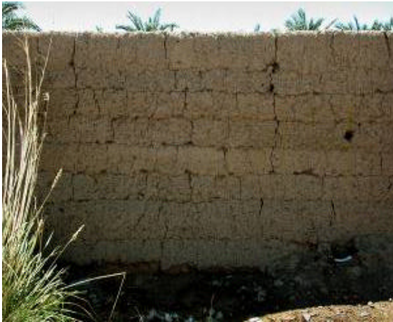
Figura 23. I muri dei giardini in chineh , probabilmente di realizzazione recente, a Baravat (vicino Bam). Mostrano le crepe che comunemente esistono su questo tipo di muratura e come la costruzione a strati aiuti ad assicurare stabilità permettendo alle sezioni fesse d’argilla di comportarsi come grossi blocchi di muratura.
