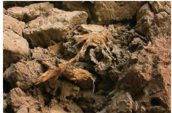
Figura 12. Veduta di una sezione di muro crollata a causa del terremoto che mostra il legno consumato dalle termiti.
