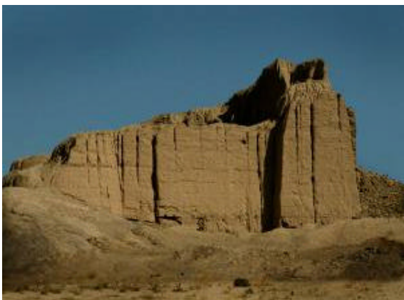
Figura 28. Il Khale Dokhtar non restaurato, una piccola cittadella sulla riva opposta del fiume che è sopravvissuta al sisma con il crollo di alcuni archi. Le alte mura dell'imponente struttura sono rimaste intatte. (Dove si sono verificati i crolli erano presenti le termiti e gli altri insetti).
