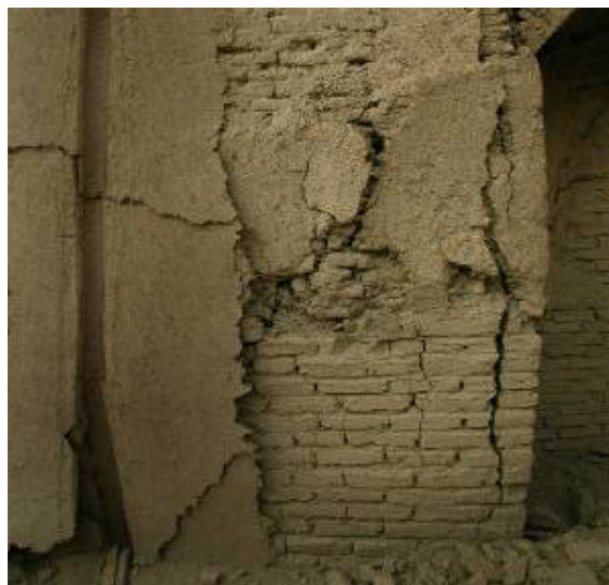
Figura 8. Pilastro in una sezione parzialmente crollata del Caravanserraglio che mostra lo scoppio degli strati più esterni dovuti all'espansione interna del nucleo per le vibrazioni del terremoto.
