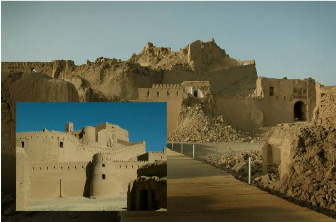
Figura 1. La cittadella superiore dell’arce di Bam prima e dopo il terremoto. La foto presa prima del sisma è di James Conlon, 2003.
