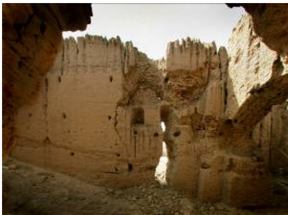
Figura 20. L'interno non restaurato della parete dello "Shahrbast" mostra l'altezza di tre piani che è sopravvissuta al sisma. Si noti la parte più antica con quelle più recenti costruite attorno. È un buon esempio dell'inizio del danno all'interfaccia di opere realizzate in tipi ed epoche differenti, ovvero come un piccolo crollo abbia scoperto la superficie di contatto tra le due. Si notino i detriti a terra.
