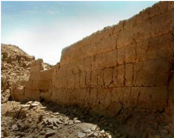
Figura 5. Mura in chineh all'interno della cittadella di Bam che erano solo poco danneggiate dal terremoto.
